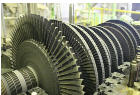
▲蒸気タービンの内部
