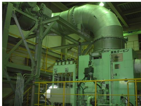
▲蒸気タービン・発電機
