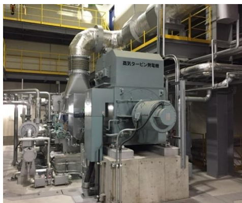
▲発電用蒸気タービン
