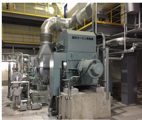
▲発電用蒸気タービン
